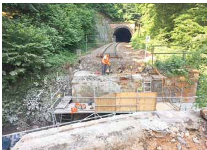
An der Harrasmühlenbrücke erfolgen Ende Mai die Vorbereitungsarbeiten an den Widerlagern für den neuen Überbau.
